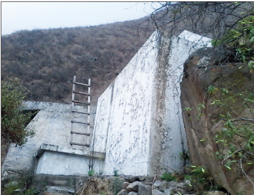
Foto 1. Reservorio en San Pedro de casta sin mantenimiento
