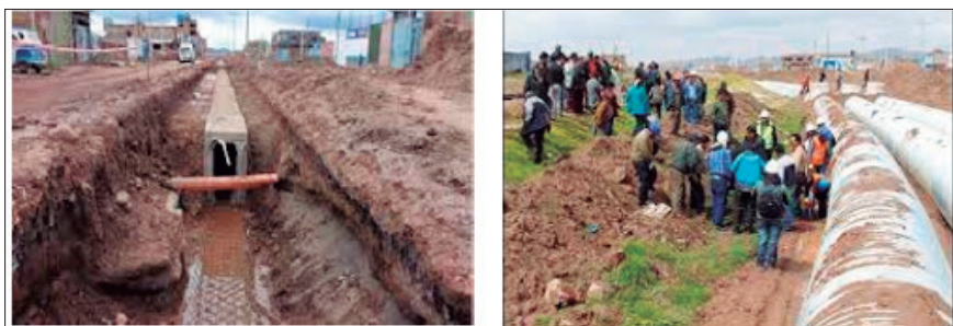
FOTO 3. DRENAJE DE AGUAS PLUVIALES DE JULIACA. URBANIZACIÓN MARGINAL
